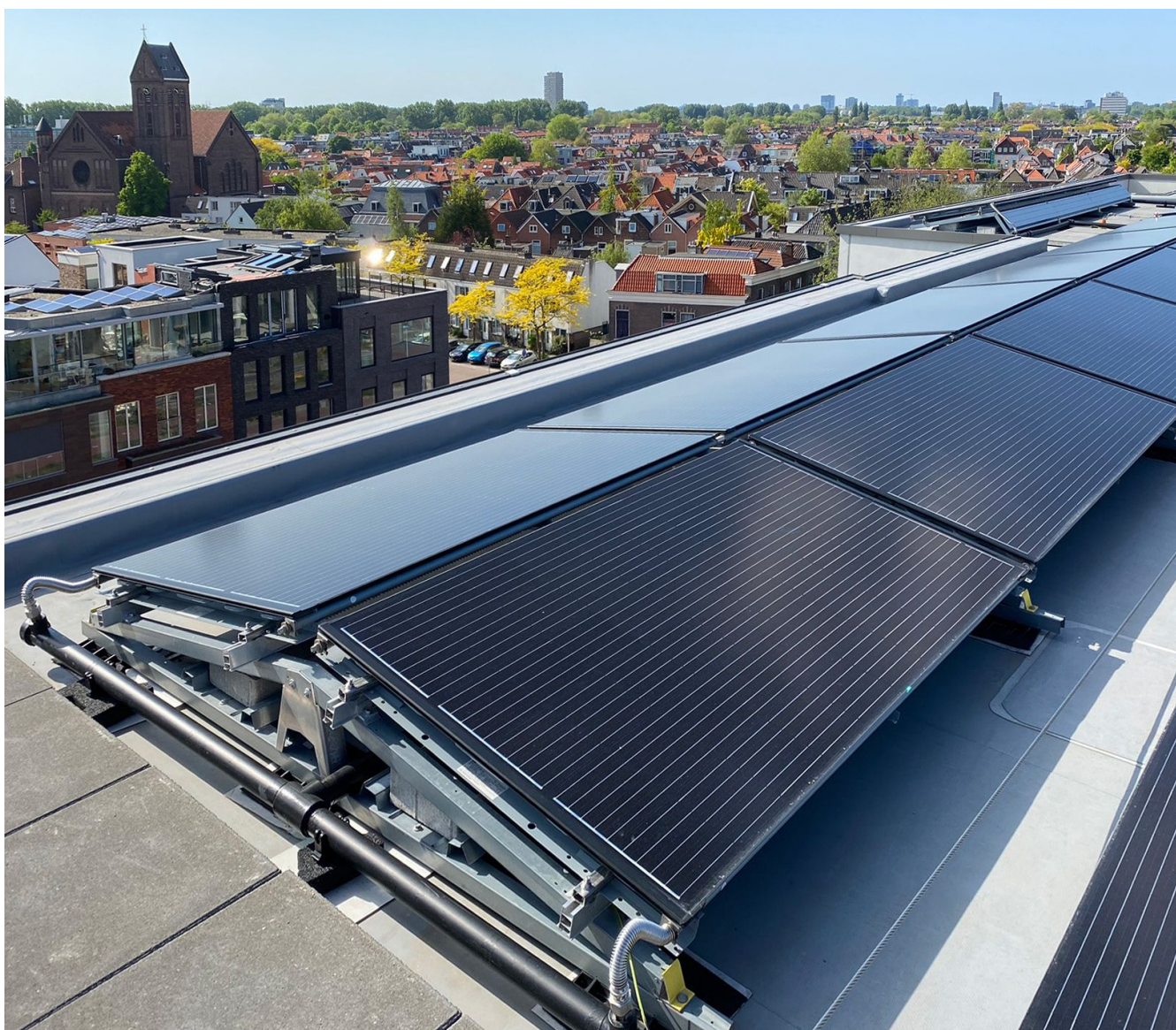
22 woningen vlakbij het station van Delft waarvan de bewoners gezamenlijk kozen voor PVT-panelen
